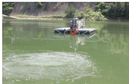
MSJ-150 縦型の設置運転状況
