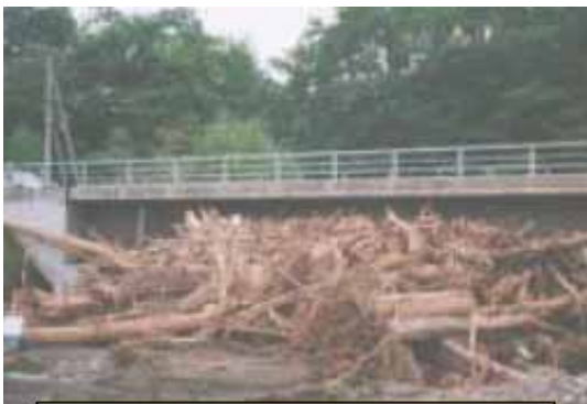
（流木による橋の河道閉塞災害）
