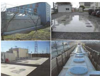
高濃度油分含有排水処理技術
