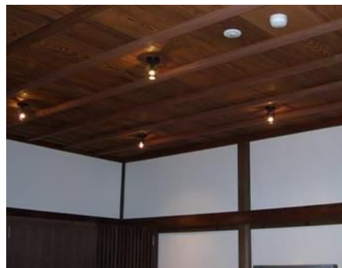
閑院宮邸の天井に設置した人感センサー
