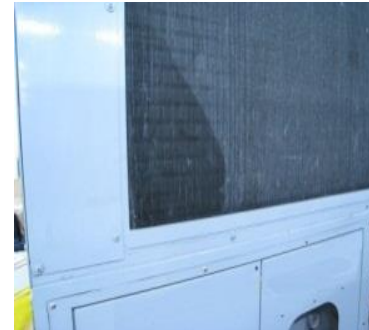
室外機の油にじみ
