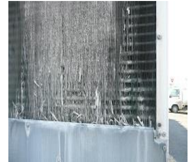
室外機の腐食
