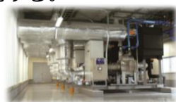
＜中央方式冷凍冷蔵機器＞
