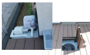
■ 集会所のポンプと 雨水タンク
