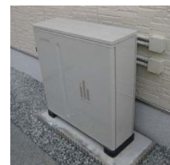
■ リチウムイオン蓄電池
