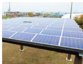
■ 共用太陽光発電システム
