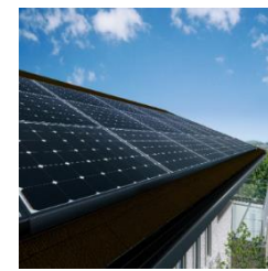
■ 太陽光発電システム
