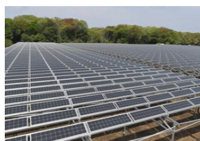
太陽光発電設備
