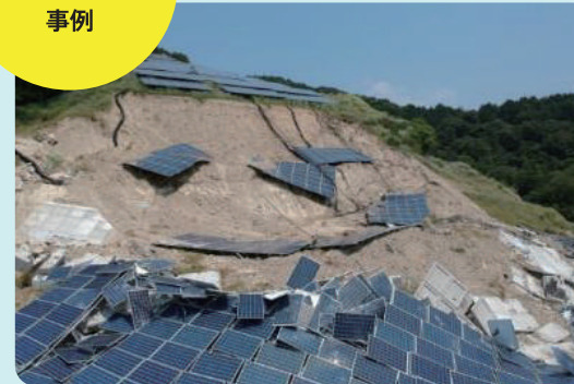
法面保護工が 崩れて流出した 事例
