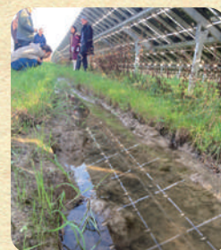
太陽光パネル下部に ビオトープの設置
