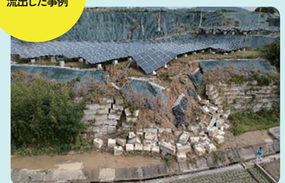
法肩部分の架台が 流出した事例
