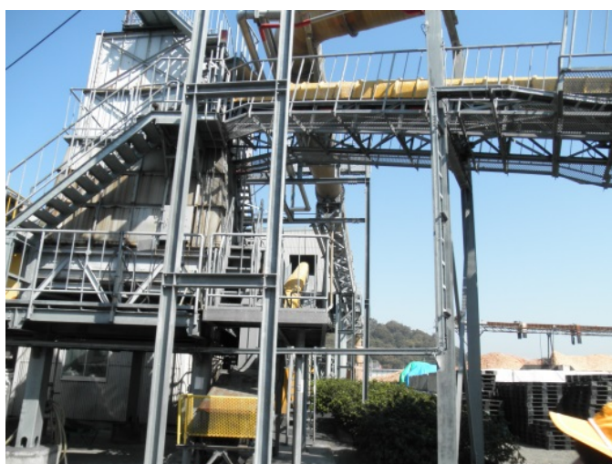
Fig.19 最終ペーパースラッジ炭化装置
