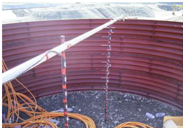
図 3.1.6-2 比抵抗トモグラフィ用のケーブル(設置状況)
