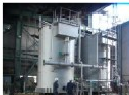
M市J水源地 4,500m 3 /日 屋外型ケミレス
