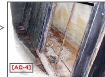
空調機AC-4の内部
