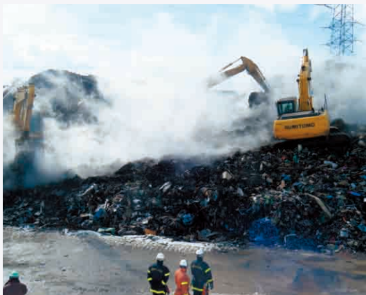
仮置場における火災の発生
