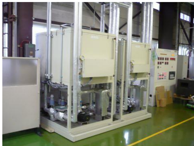
写真 4-4 一次側熱媒（水）の定温設定用の水タンクとポンプ、流量計（試験室外に設置）
