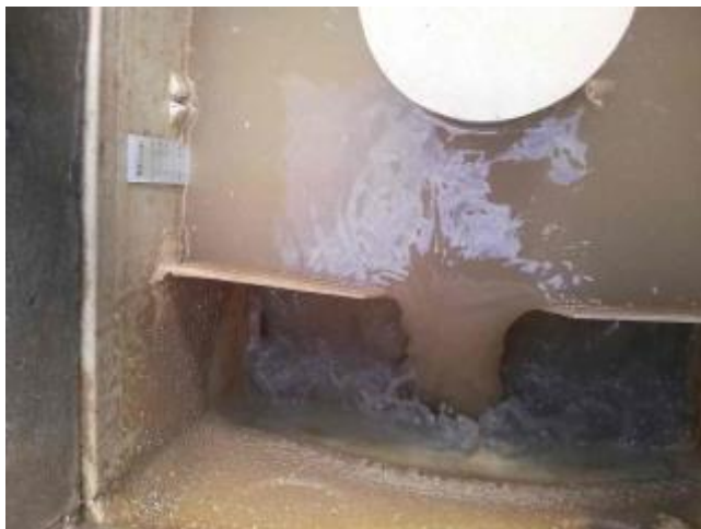
上：流量調整槽 左：担体流動槽の汚泥
