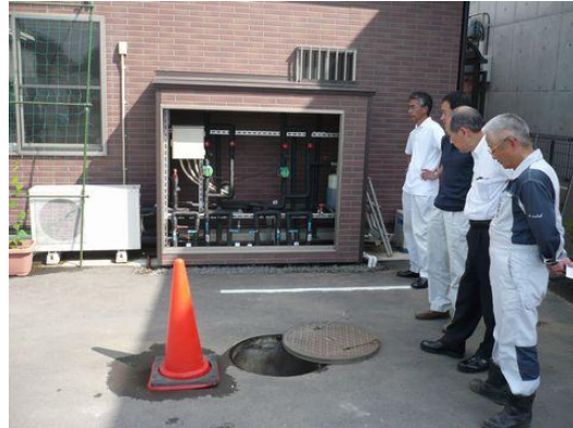
写真2 システムの全体配置 (手前が地中熱交換井)
