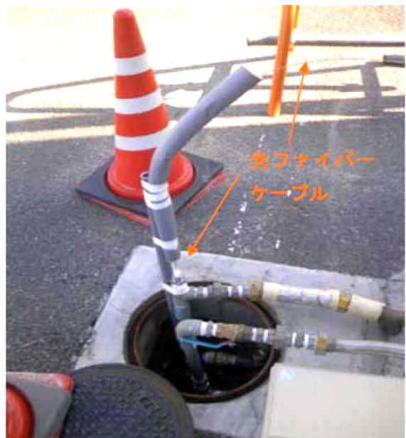
地中熱交換井と光ファイバーの写真
