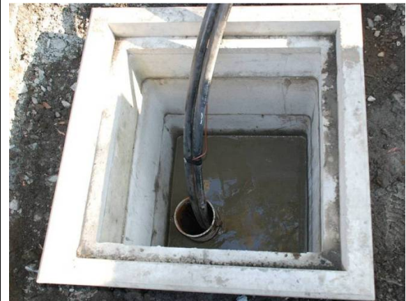
先端閉塞の回転貫入鋼管杭の頭部にコンクリート製榘を設置し、鋼管杭内部に循環水パイプ (ポリエチレン製) を挿入
