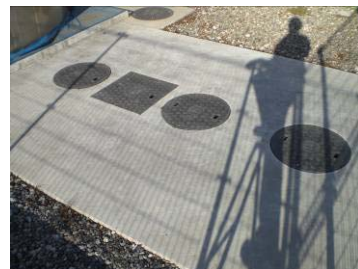
沈殿分離槽(埋設)
