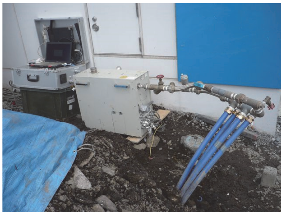
写真3 加熱循環配管の状況
