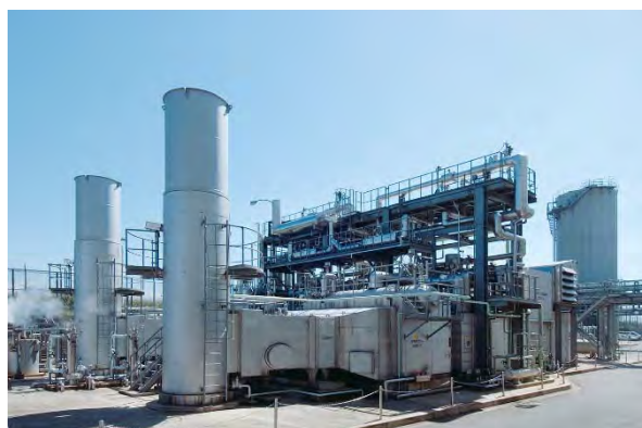
図 4.3-16 コージェネレーションシステム
