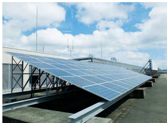
図 4.3-7 NAA 本社ビル屋上の太陽光発電パネル
