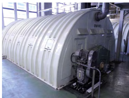
図 4.2-16 厨房排水除害施設
