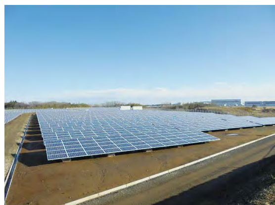
図 4.3-8 三里塚太陽光発電所
