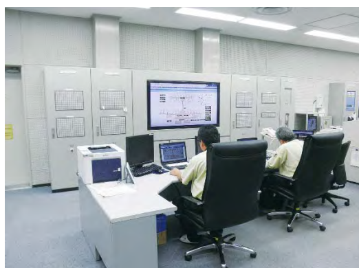
図 4.3-13 第 2 旅客ターミナルビル内の中央監視室
