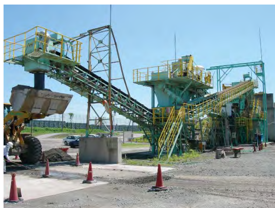
写真 10.13.1-1 空港内のリサイクルプラント
