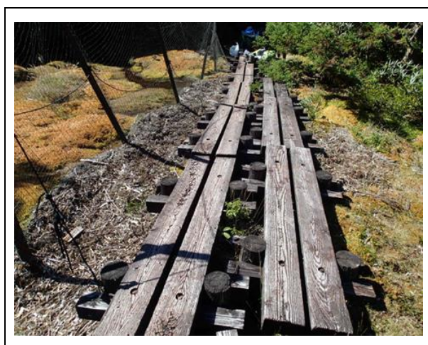
写真1 植生保護柵、木道に溜まった枝条
