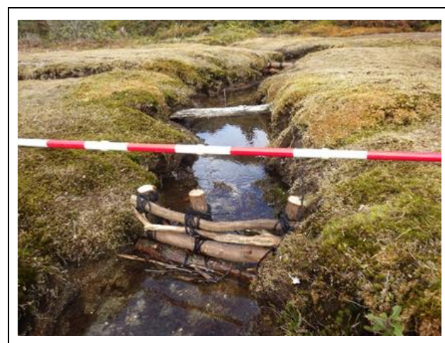
写真2 局所的に流路の浸食が発生
