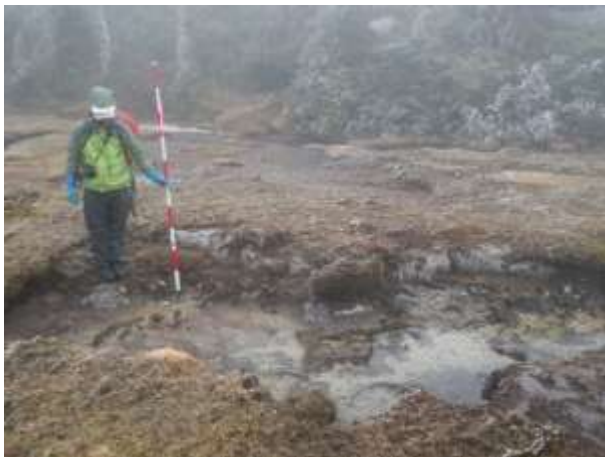
流路の洗掘状況（年々深くなっている）
