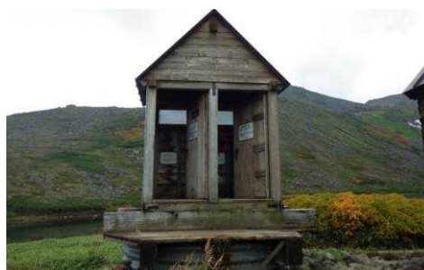
老朽化したヒサゴ沼避難小屋のトイレ棟
