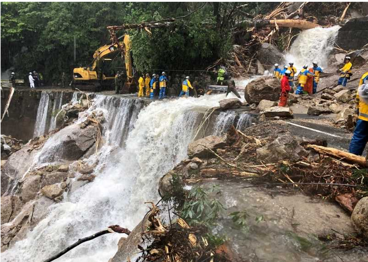
令和元年5月豪雨による被災
