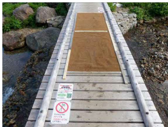
設置後の様子
