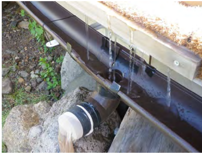
南竜（南竜道） 雨水対策の雨樋
