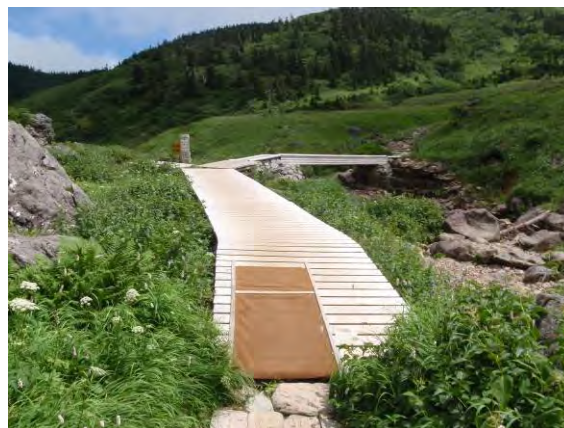
設置後の様子
