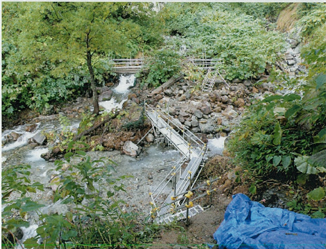
9月17日ヤンベタツ沢の架橋完成。町道も複数箇所崩壊し、架橋工事の車輛が通れなかった ので、約1カ月のクローズとなりました
