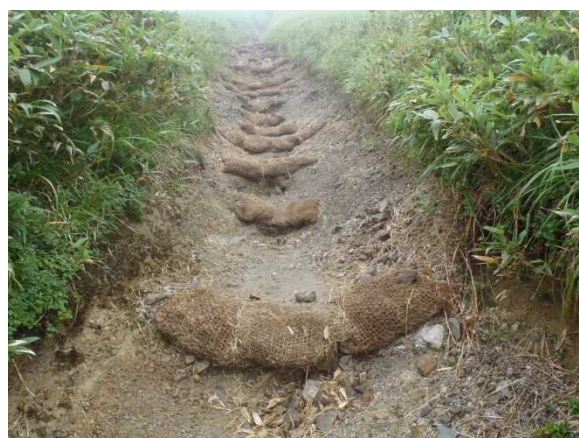
水路化区間の床止工 段差が生じている 土嚢の追加設置が必要 (施工2～3年後) 飯豊連峰(2014. 8. 21)
