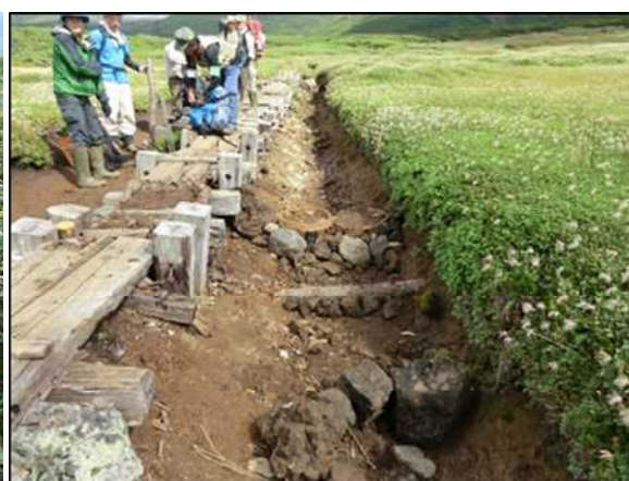
木道の基礎部分の洗掘を防ぐ
