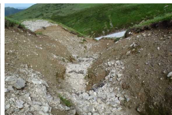
土砂が堆積 施工2年後
