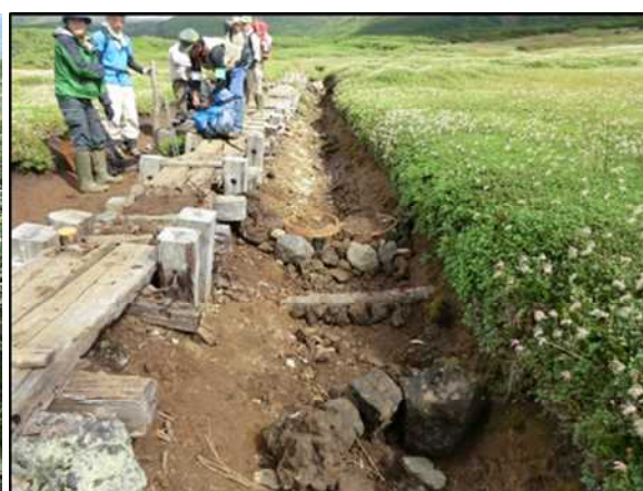
木道の基礎部分の洗掘を防ぐ
