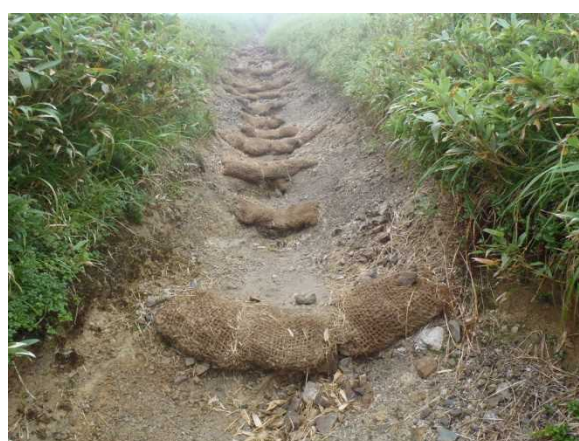
水路化区間の床止工 段差が生じている 土嚢の追加設置が必要（施工2～3年後）
