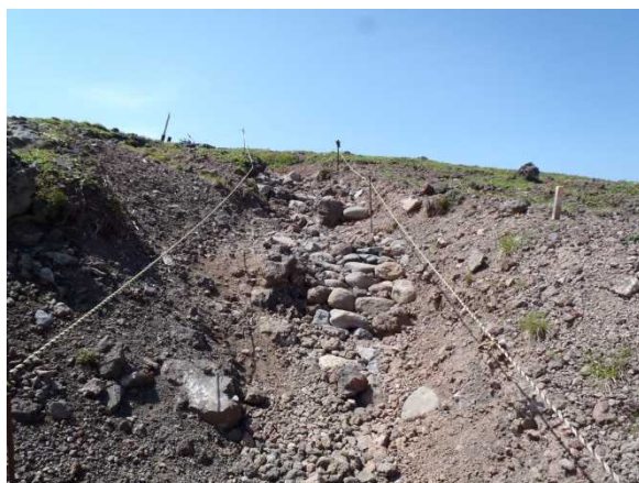
自然景観になじんでいるが侵食が生じている
