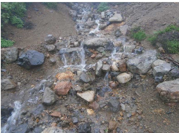
裾合平 2006年施工 2014年崩壊・補修
