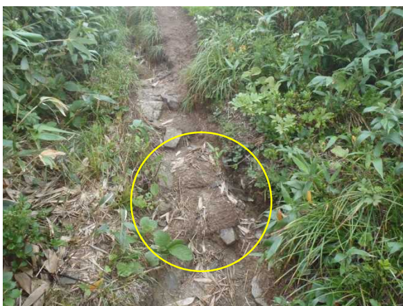
土砂詰まり固くなったヤシ製土囊 ステップとして設置（施工2～3年後）
