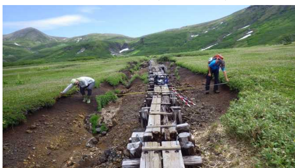
木道が老朽化し侵食も拡大 裾合平(2013.8.10)
