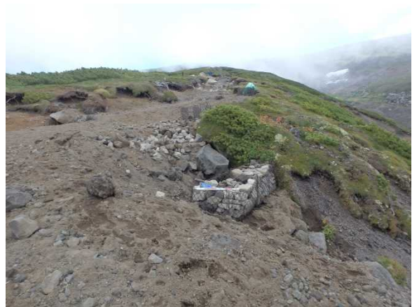
上部の登山道に分散排水がなく水量は同じ フトン籠下部の侵食進行が懸念される
