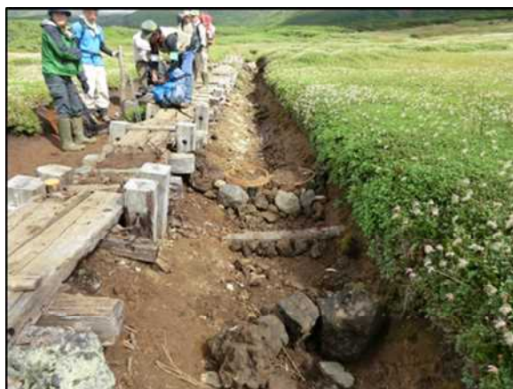
木道の基礎部分の洗掘を防ぐ
