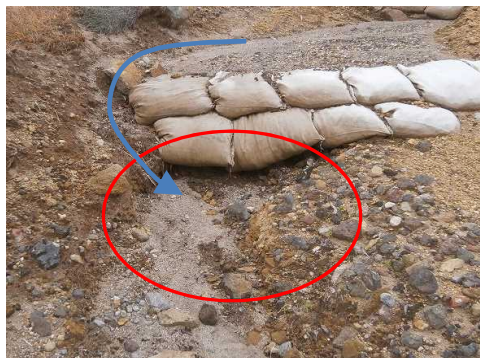
中岳分岐付近 2012. 8月施工 2014. 9月補修
