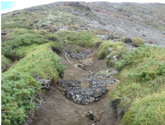
水みちのフトン籠は比較的目的立たない 落差が大きいため水叩き部の洗掘が懸念される
