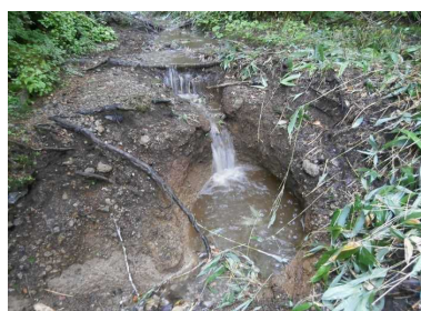
流水の落下による洗掘
