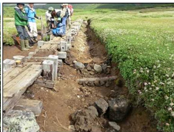
木道の基礎部分の洗掘を防ぐ
