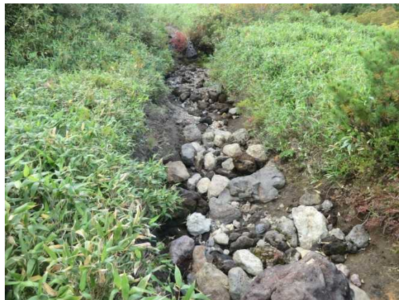
石組周囲が洗掘されている
