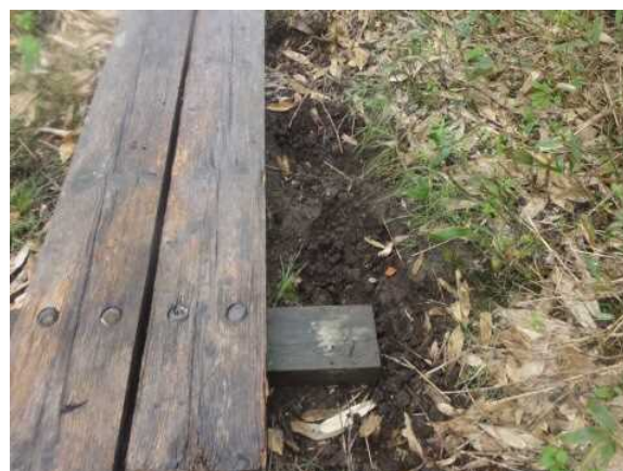
流水が施設に当たることで生じる侵食
