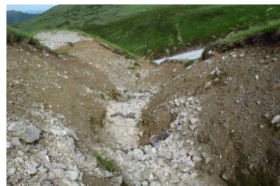
土砂が堆積 施工2年後
