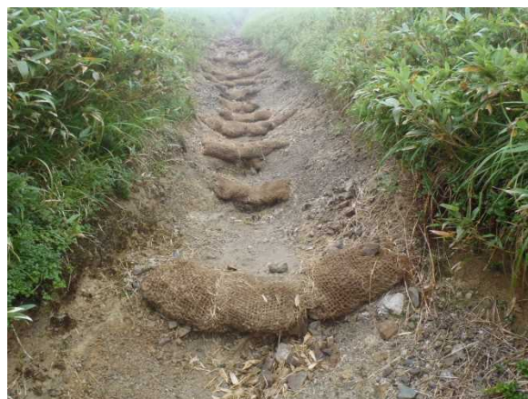
水路化区間の床止工 段差が生じている 土嚢の追加設置が必要 (施工2～3年後)
