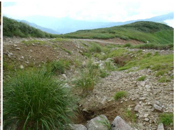
左箇所の植生回復の状況 (飯豊連峰・施工7年後)
