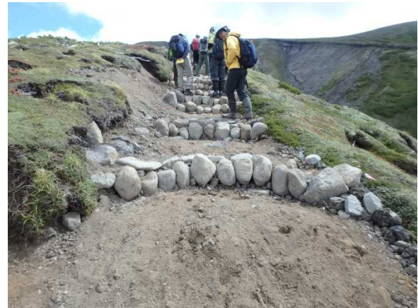
〔課題あり〕 画一的な素材を機械的に 配置した公共工事の例 中岳温泉上部～中岳分岐間(2014.8)
