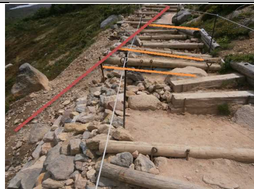
毎年崩れる場所（姿見の池園地） 木柵が高く法面に逆らう角度になっている。
