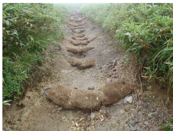
水路化区間の床止工 段差が生じている 土囊の追加設置が必要（施工2～3年後）
