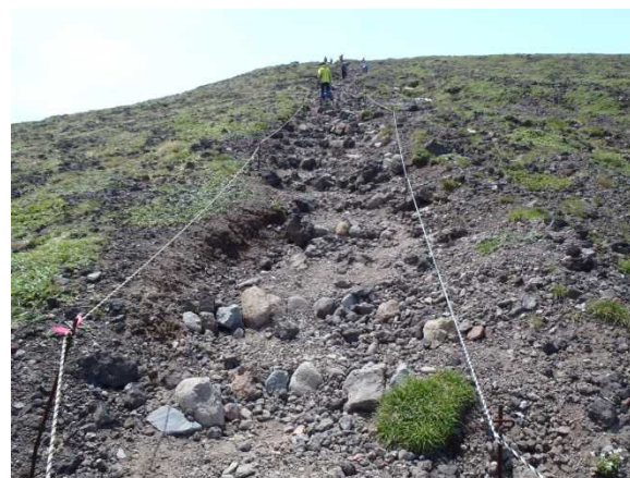
石を置いただけの石組になっていない施工
