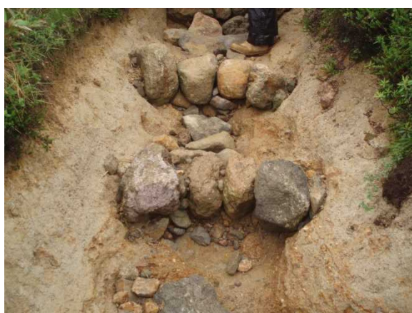
石組周囲に生じた洗掘
