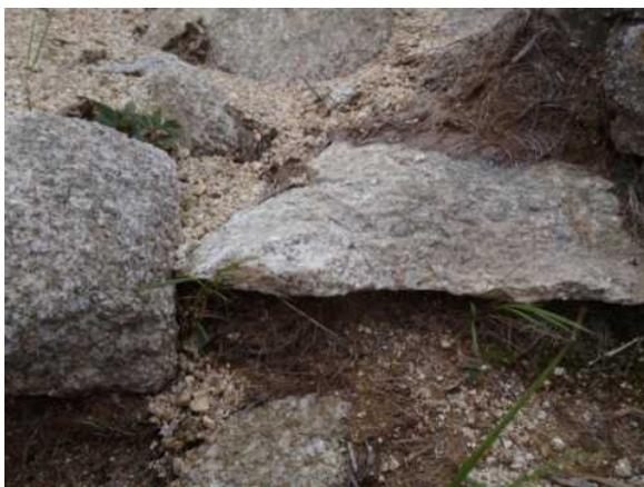
間詰のヤシ繊維に植物生育
