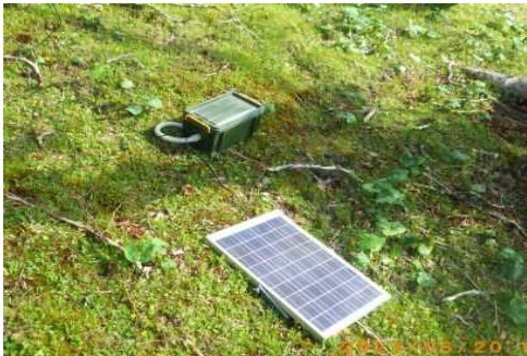
写真 II-9 中継機の電源供給部分
