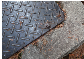
グリストラップの蓋は ボルトなどでしっかりと固定
