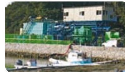
水処理プラント
