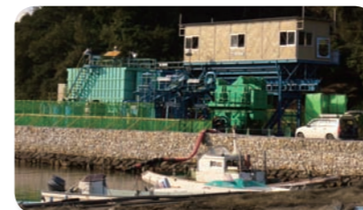
水処理プラント
