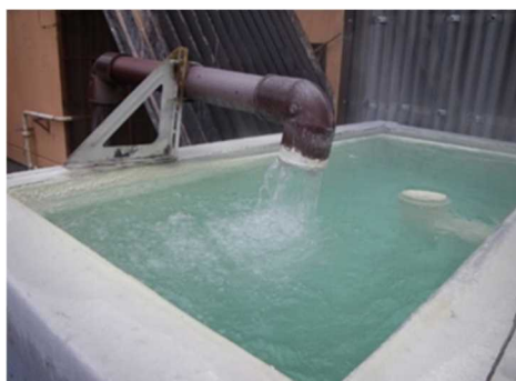
図 2 落下式ばっ気槽
