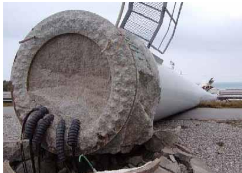
宮古島七又1号機(H15年台風14号被害)
