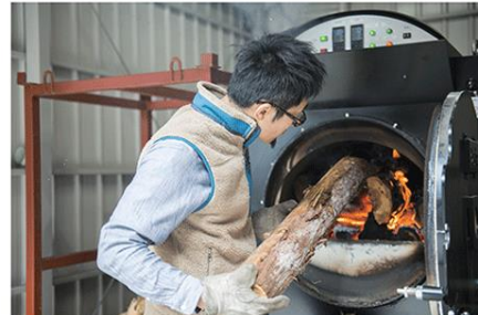
温泉施設の薪ボイラー (資料: 西栗倉村)
