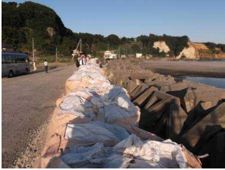
常磐共同火力周辺地区の津波被災状況(道路堰堤補強)
