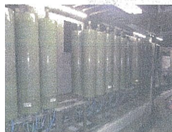
ROユニット
