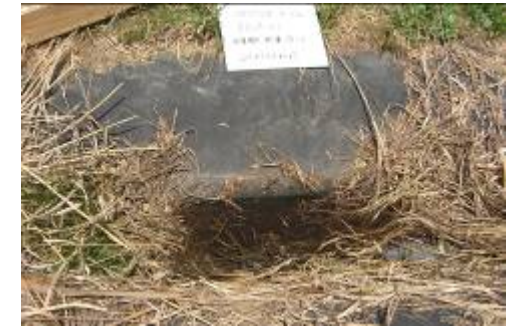
濃度の高い水が検出された側溝の状況
