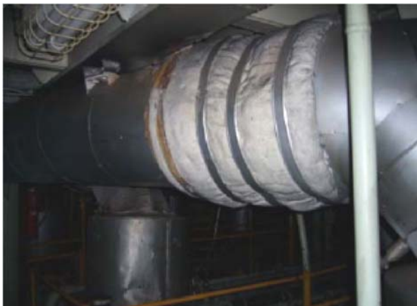
配管部分のアスベスト布団
