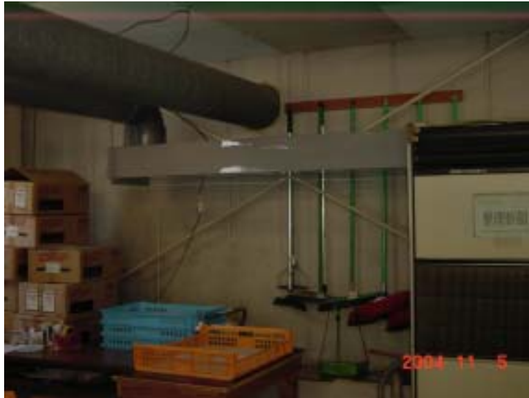
写真2 エアコンからの配管の様子
