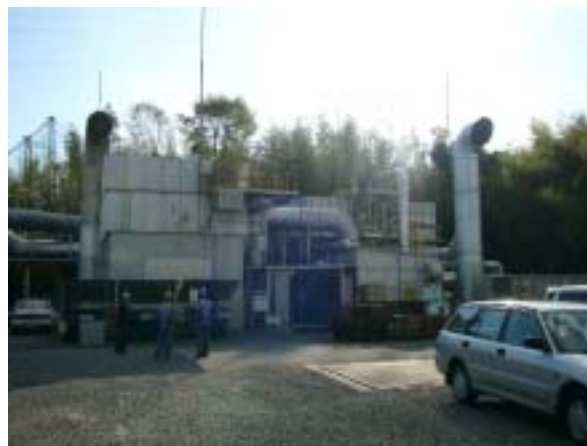
写真1 増設した蓄熱燃焼脱臭装置の様子
