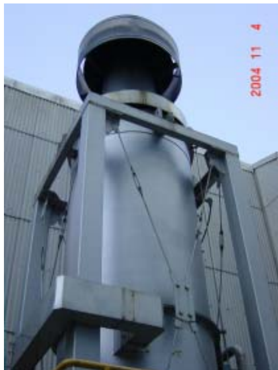
写真 1 排ガス処理装置の外観
