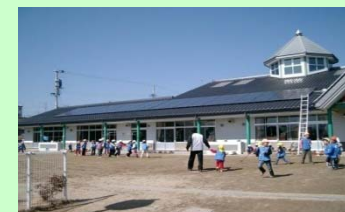
市民出資により幼稚園に設置された太陽光パネル
