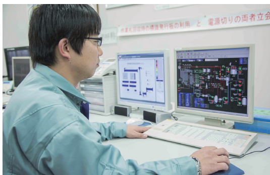
発電プラントの現状を伝える画面。刻々と変わる数字などのデータをチェックし、気になることがあれば現場に足を運ぶ
