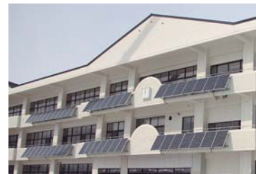
坂下東小学校のベランダに設置された太陽光パネル
