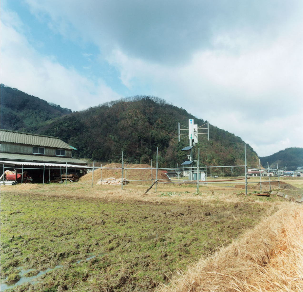
市内の農場「タケチャン・ファーム」では、農作業場のすぐ横に風力発電を設置。電力は場内の照明などに使っている。
