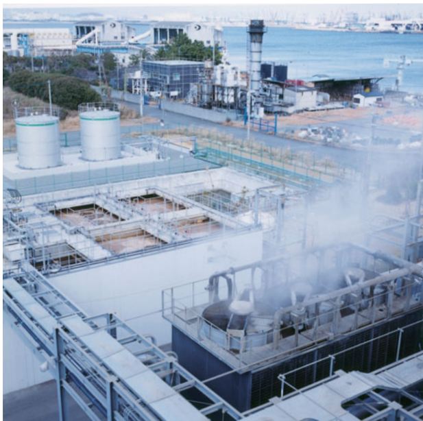
エタノール製造の最終工程となる濃縮、蒸留、脱水設備。使用された水は、敷地内の排水処理設備でバクテリアが分解することにより浄化され、再利用される。
