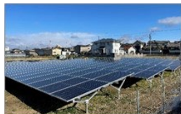
関西電力様設置の太陽光発電所 (現在耕作が行われていない土地を有効活用)
