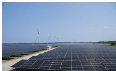
北陸電力グループ様設置の太陽光発電所(北陸地方のセブン-イレブン店舗へ供給)
