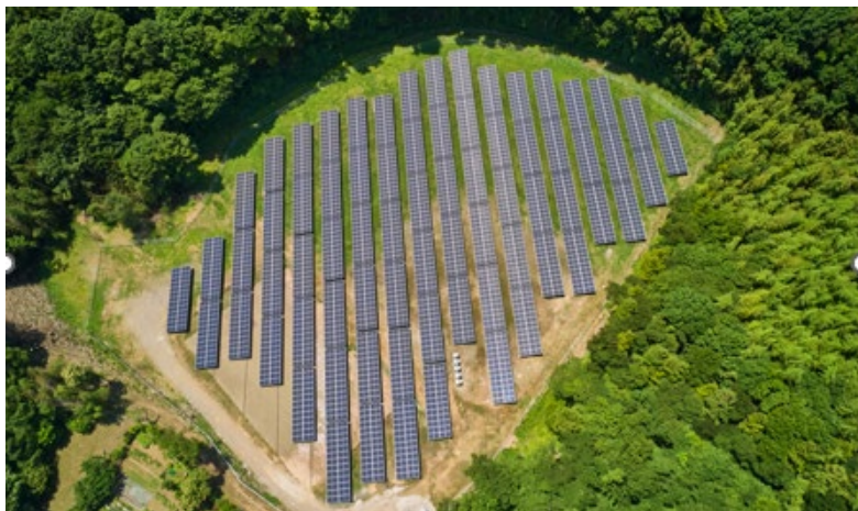
NTTグループ様設置の太陽光発電所 (使われなくなった野球場を有効活用し、首都圏のセブン-イレブン・イトーヨーカドーの一部店舗へ供給)
