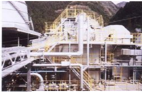
木くずだきボイラー
